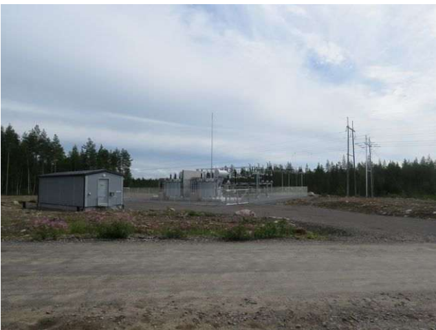
Kuva 31. Alajoki-Peuralinna tuulipuiston sähköasema, itään.
