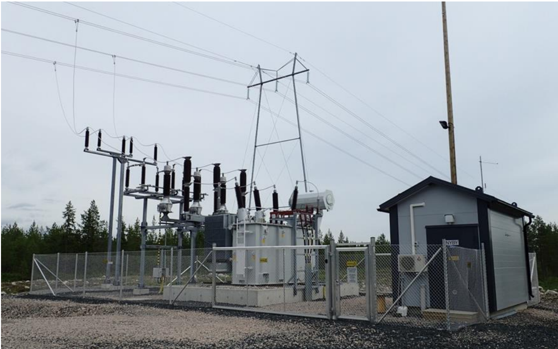
Kuva 75. Esimerkki tuulivoimapuiston sähköasemasta (kuva Minna Takalo/FCG).
